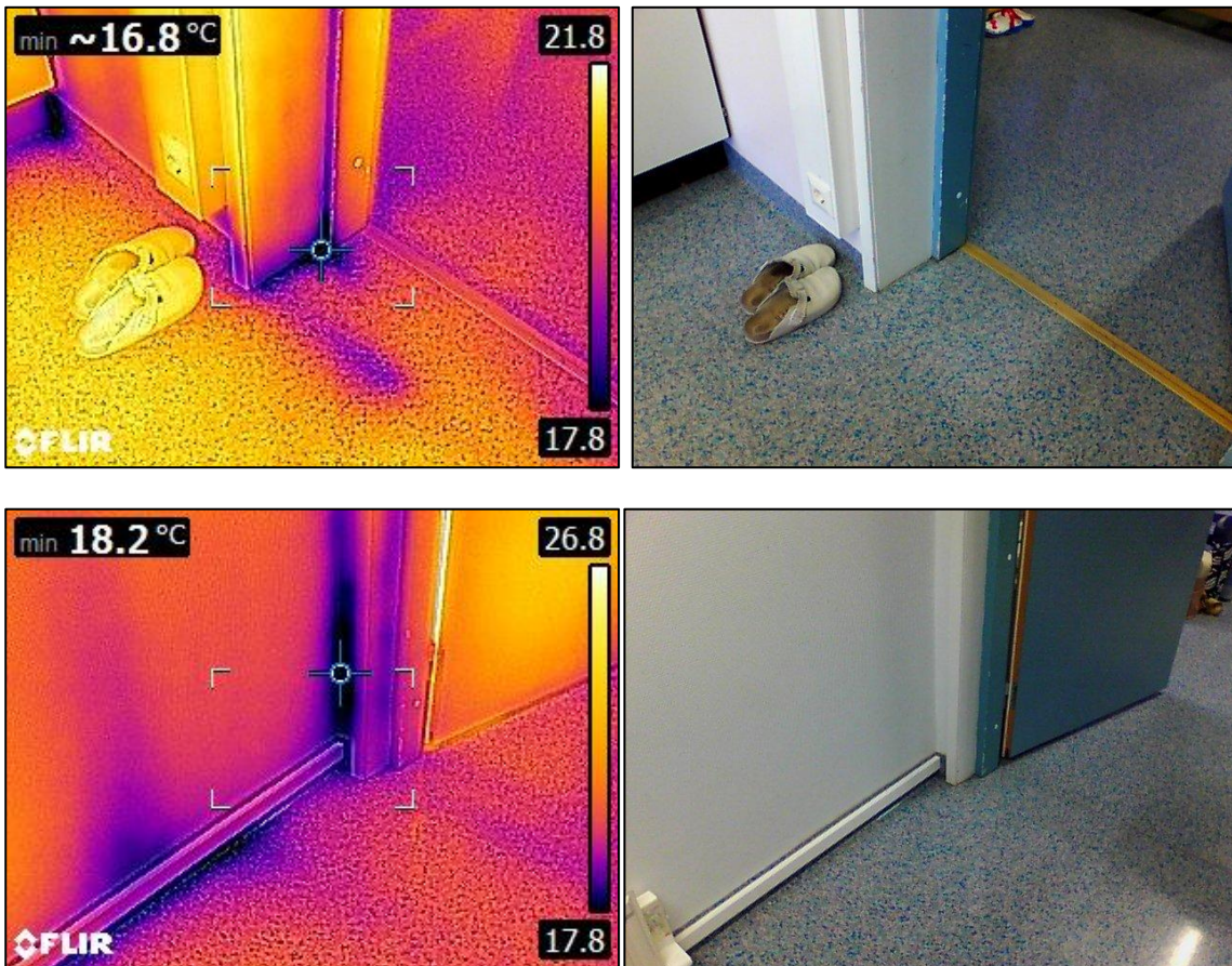
Kuva 3.5. Esimerkkejä lämpökameralla tehdyistä havainnoista.
