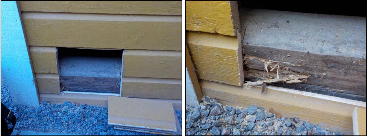
Kuva 2.10. Yleiskuvia rakenneavauksesta AV8: hirressä esiintyy lahovaurioitumista.
