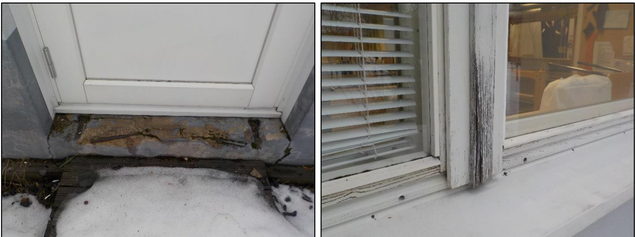
Kuva 2.14. Esimerkki ulko-ovella esiintyvistä betonisokkelin lohkeilusta betoniterästen korroosion takia. Vasemmalla on yleiskuvaa ikkunoiden kunnosta auringon puolella.
