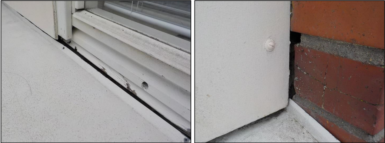
Kuva 2.13. Julkisivuilla on useita paikkoja, joista sadevesi voi tunkeutua ulkoseinärakenteiden sisälle ja lämmöneristekerrokseen.
