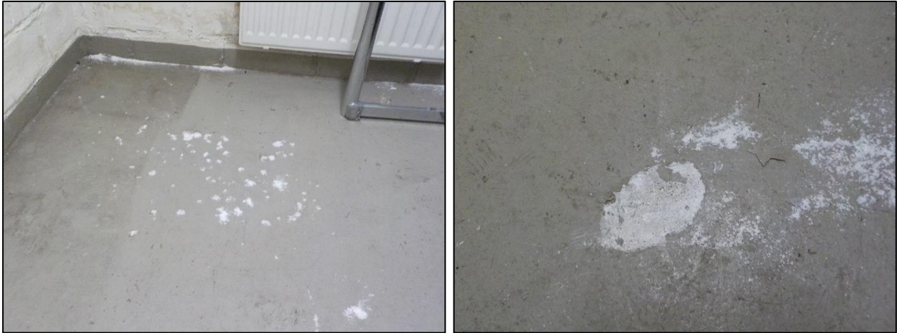
Kuva 2.3. Kellarin alapohjan betonilaatan läpi nousevan kosteuden mukana kulkeva suola kiteytyy rakenteen pintaan kalkkihärmäksi ja rikkoo maalipinnan.
