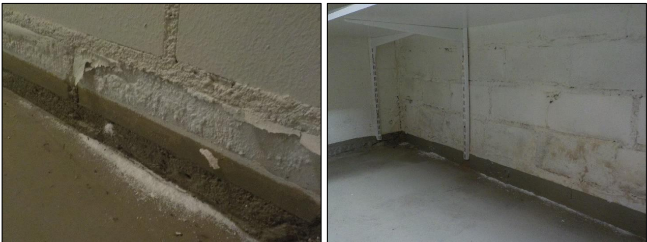
Kuva 2.8. Esimerkkejä seinärakenteiden kosteusvaurioista.
