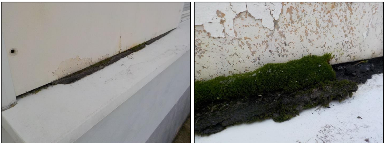
Kuva 2.12. Vesipeltien päällä kasvaa paikoin sammalta ja kasvustoa ulottuu levyverhouksen taaksekin. Kuvissa näkyy myös julkisivulevyjen pintavaurioita.
