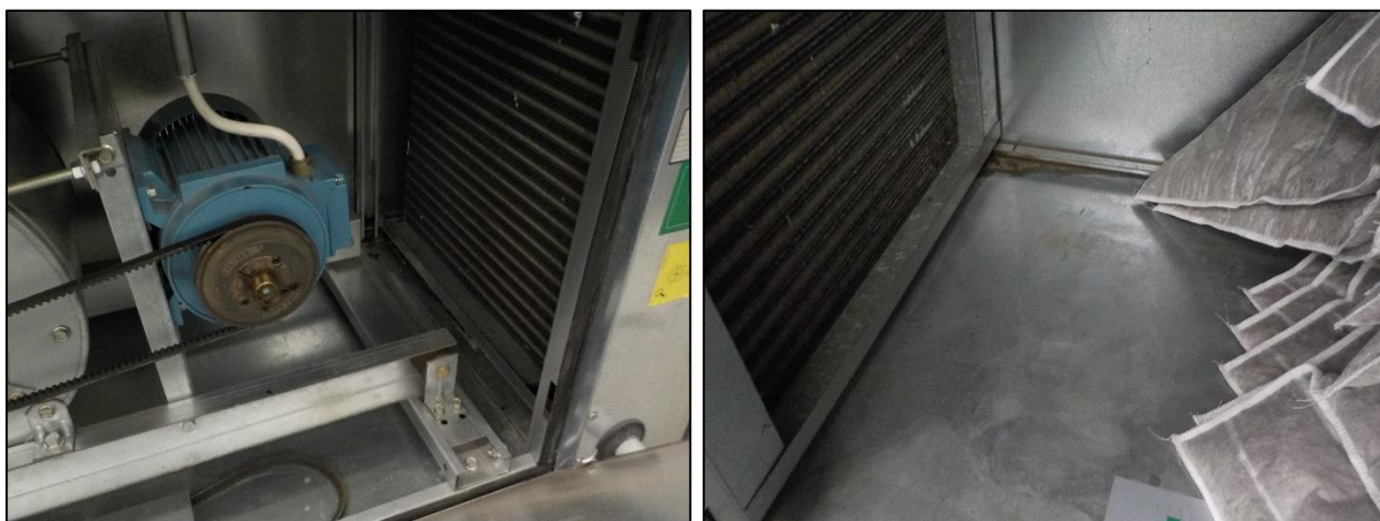
Kuva 2.19. Yleiskuvia ilmanvaihtokoneen sisältä.
