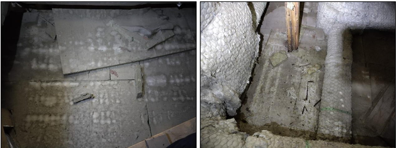
Kuva 2.19. Yläpohjan lämmöneristeissä on selkeät jäljet vesipisaroista, joita syntyy, kun kosteus tiivistyy peltikatteen alapintaan.
