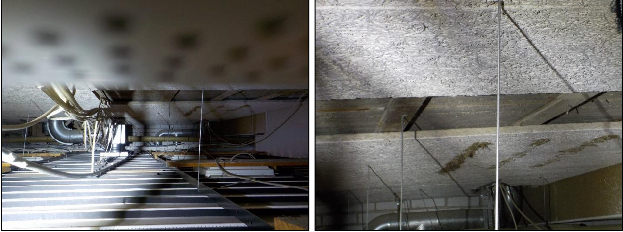
Kuva 2.18. Yleiskuvia alaslaskujen sisältä: tojalevyjen kiinnitykseen on käytetty likaisia lautoja, jotka ovat todennäköisesti olleet työmaalla aiemmin käytössä muottilautoina.
