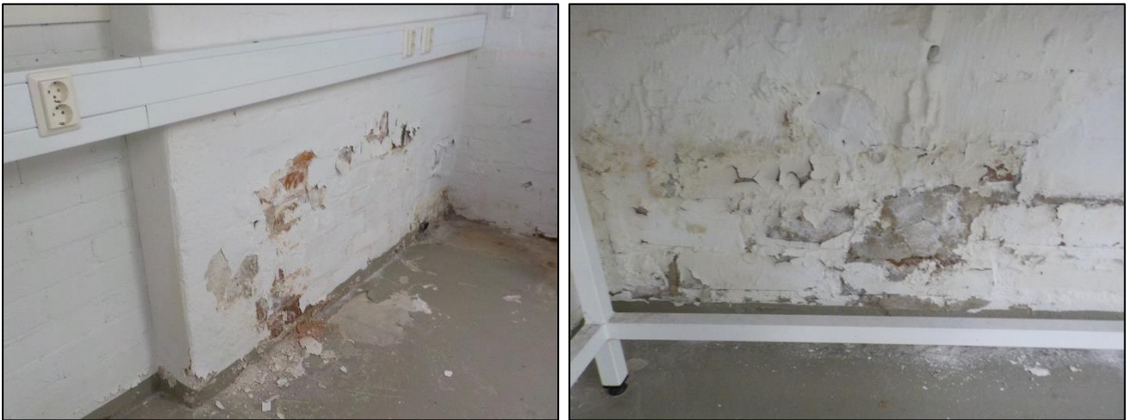
Kuva 2.7. Esimerkkejä kellarin seinärakenteiden kosteusvaurioista.
