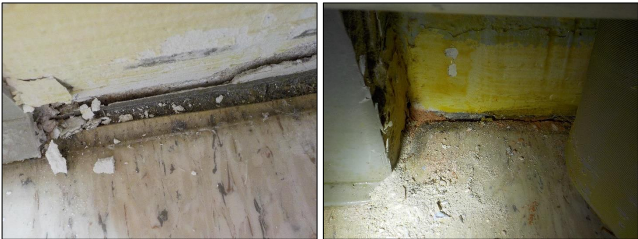
Kuva 2.31. Pistokokein tehtyjen rakenneavausten perusteella ilmavuotoreitti alapohjan pintabetonilaatan ja ulkoseinän sisäkuoren välillä on jatkuva. Liitosta peittävän muovilistan osalta tiiveys vaihtelee.
