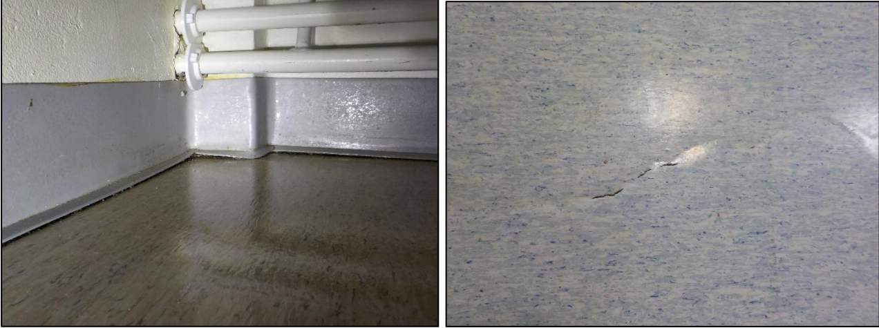
Kuva 2.5. Vasemmalla on yleiskuva mahdollisesta alapohjan painumasta ja oikealla esimerkki muovimaton repeämästä keskilattialla.
