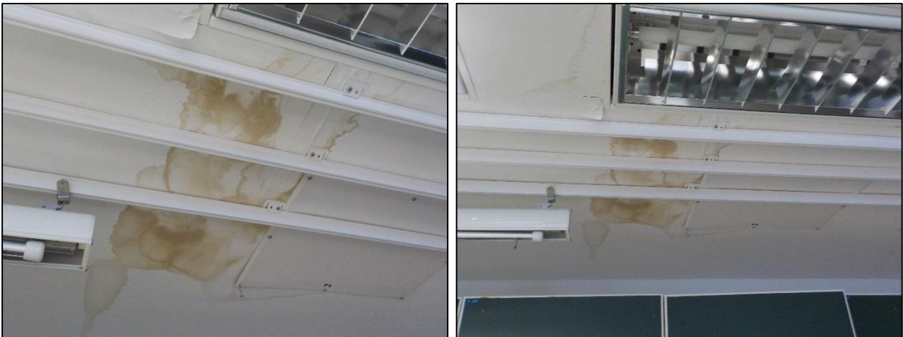
Kuva 2.17. Esimerkki sisäkattorakenteen kosteusjäljistä.
