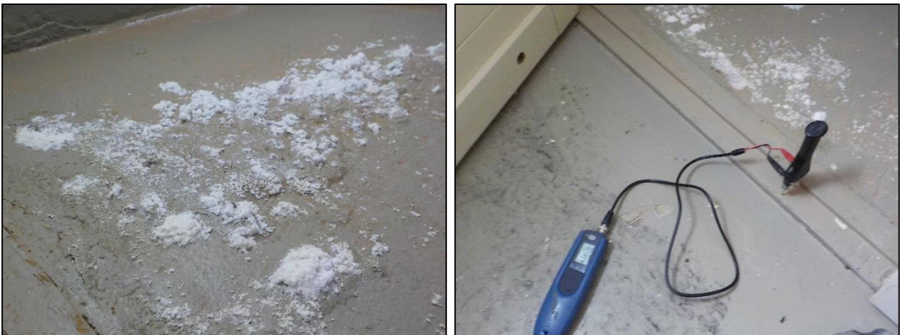
Kuva 2.4. Kellarissa alapohjan betonilaatan pintaan on muutamissa kohdin muodostunut runsaasti kalkkihärmää. Tämä korkea kosteusrasitus mahdollistaa osassa kynnyksistä ja karmeista puurakenteiden kosteusvaurioitumisen.
