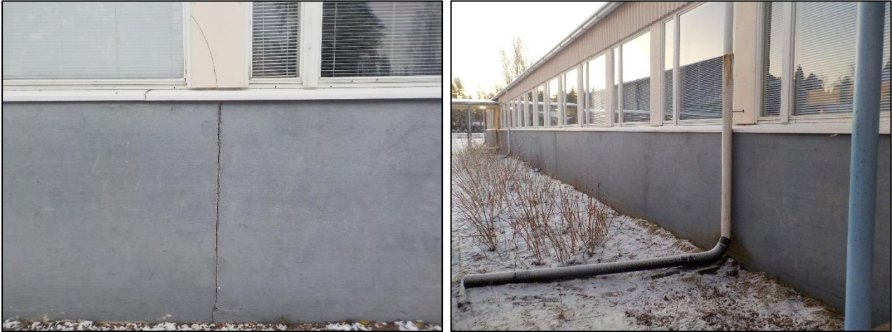
Kuva 2.14. Sokkelin betonirakenteessa esiintyy noin joka toisen pilarin kohdalla pystysuuntainen halkeama. Vasemmalla kuvassa oleva sauma on liikuntasäuma, jossa elastinen saumamassa on revennyt irti auki.
