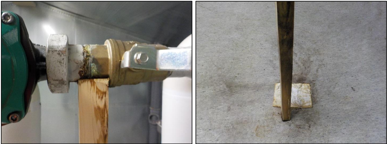
Kuva 2.23. Tuloilman lämmityksen kiertovesipumpun ja tämän yhteydessä olevan sulun putkiliitos vuotaa ja valuttaa vettä lattialle. Tuentaa lattialla seisovan kiinnittämättömän puutolpan varaan ei pidetä hyvän asentamistavan mukaisena.
