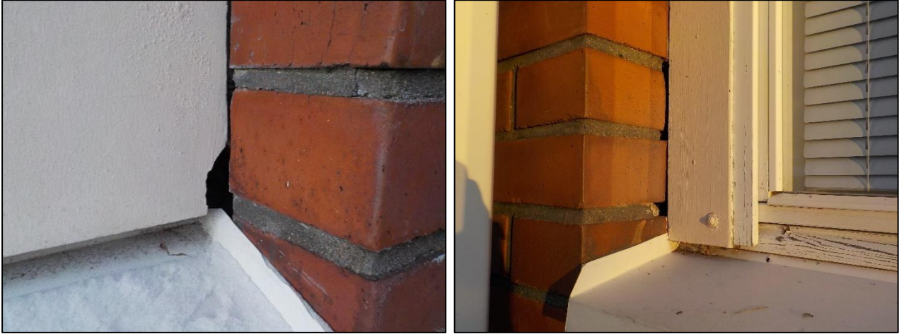
Kuva 2.16. Julkisivun liitokset ikkunoiden ympärillä ei ole vesitiiviitä viistosaderasitusta vastaan.
