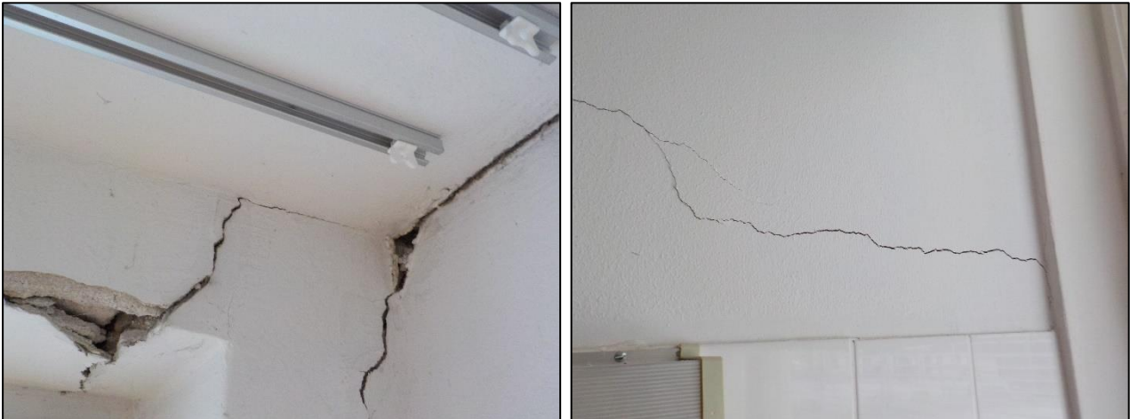
Kuva 2.15. Esimerkkejä halkeilusta: vasemmalla on pilari-palkkirungon liitosta ulkoseinällä ja vasemmalla väliseinän halkeama.
